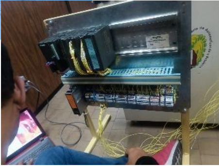
Figura 4 Estación de control centralizado
